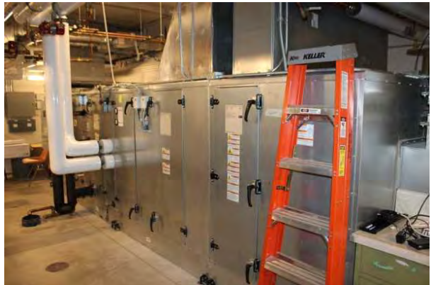
#46 AIR HANDLER (AHU)
